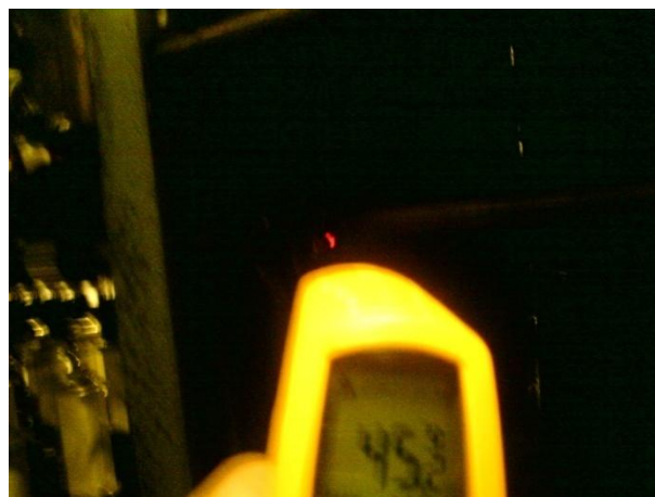
FIGURA 63 Toma de temperatura en ejes
