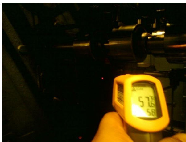
FIGURA 60 Toma de temperatura en leva
